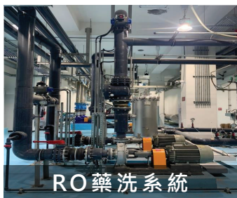
RO保安過濾器/加壓泵
