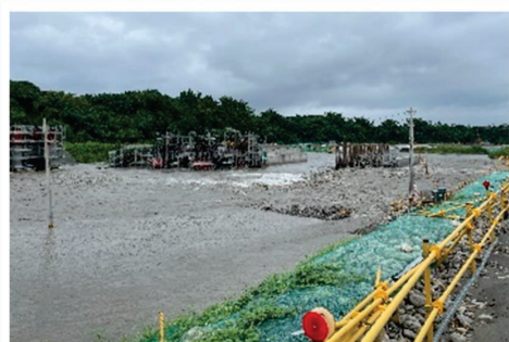
進水口施工期間遭大水沖毀
